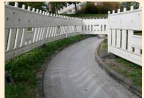
Sieht solide aus: Die Wasserachse in Winzerla wird aktuell erneuert. Je nach Witterung können die Arbeiten bis 2020 dauern. Foto: sl
