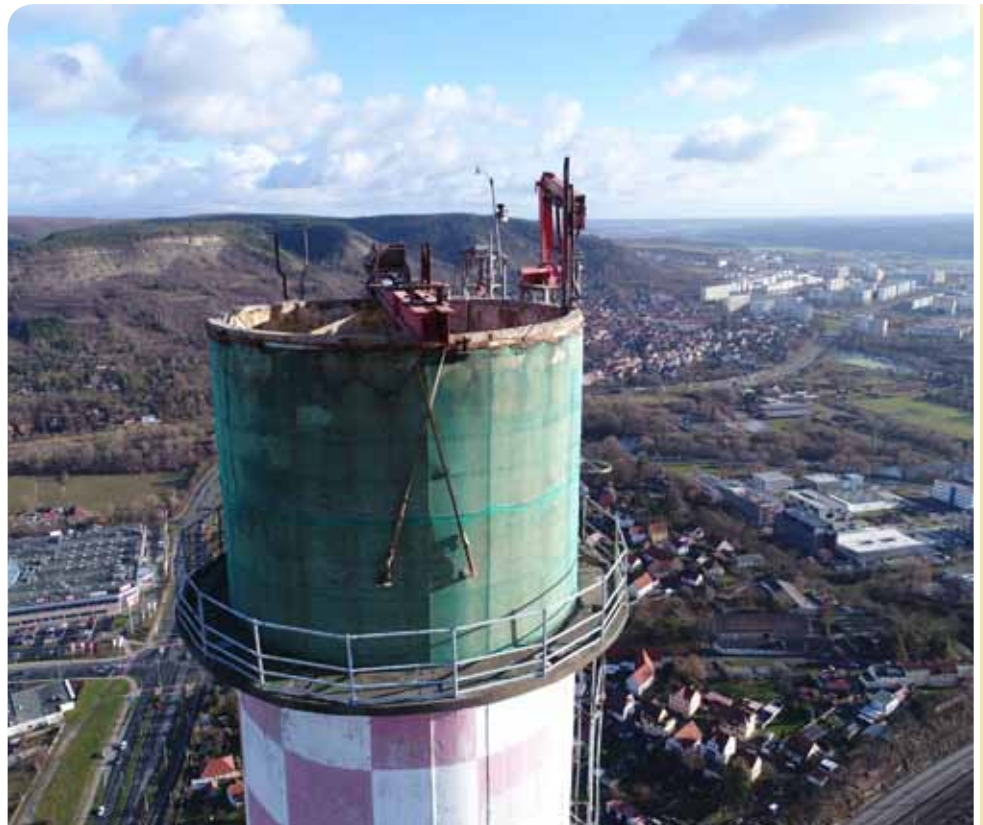
Ein ferngesteuerter Bagger frisst sich Runde für Runde nach unten. Der Maschinist muss jedoch in luftiger Höhe dabei sein. Foto: Teag
